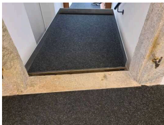
Hublift zur Treppe
