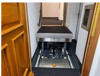
Hublift zur Treppe
