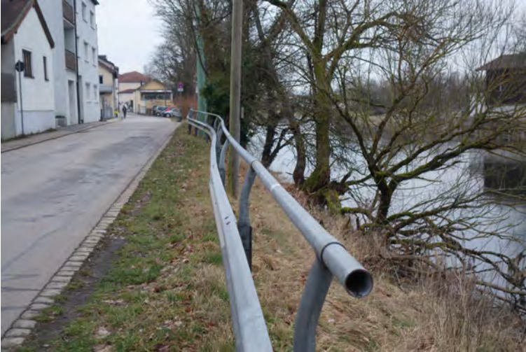
Der Straßenraum in der Unteren Regenstraße hat gestalterische und bauliche Mängel, der Gehweg ist schmal, das Regenufer ist unzugänglich
