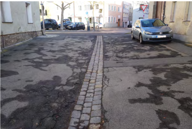
Teilweise haben Altstadtstraßen bauliche Mängel, wie hier am Birkenstein
